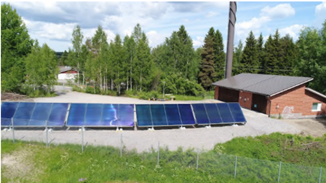
Kuva 4 Ristiinan koulukeskuksen lämpökeskus toimii puuhakkeelle ja auringolla. (Etelä-Savon Energia, 2024)
