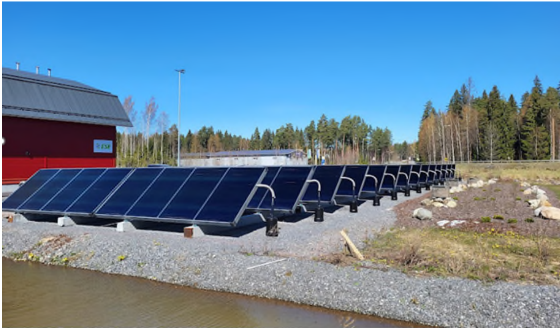
Kuva 3 Mikkelin Tuskuun, valtatie 13 varrelle on valmistunut Suomen suurin maa-asenteinen aurinkokeräinpuisto. (Etelä-Savon Energia, 2023)
